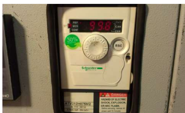
ภาพที่ 16 ชุดควบคุมอัตราเร็วของเครื่องเป่าลมร้อนแบบวงแหวน รุ่น ATV312H037M2 variable speed drive ATV312 - 0.37kW - 1kVA - 41 W - 200..240 V - 1-phase supply
