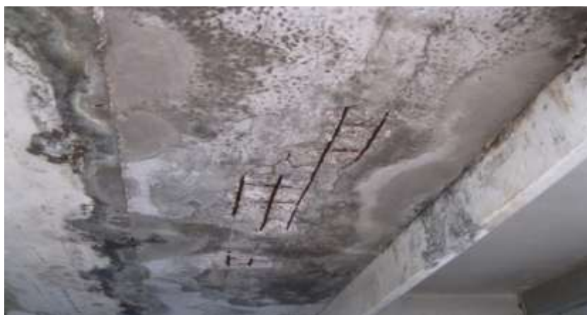
ภาพที่ 21 สภาพเพดานอาคารดนตรีที่ชำรุด
