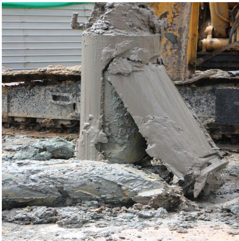
ภาพที่ 4 การขุดเจาะดินด้วยหัวเจาะแบบถัง (Bucket)
