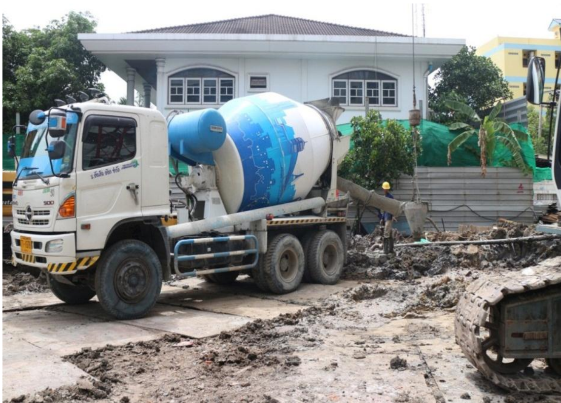
ภาพที่ 13 การเทคอนกรีตผ่านท่อTermie Pipe (กฤษฎา ภูมิ, 2559, โครงการสุขุมวิทซอย 18)
